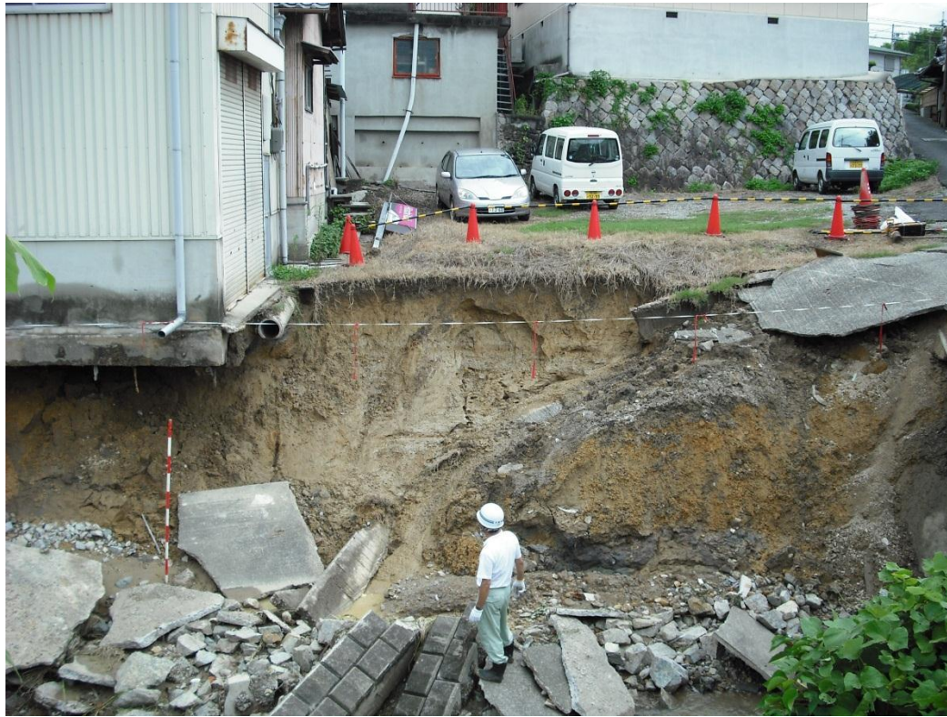
平成23年被災箇所 冬堂橋下流右岸（松尾川）
