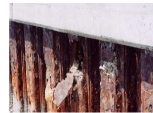
鋼矢板護岸の補修を しなかった場合のイメージ
