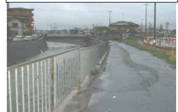
平成16年5月出水時の百済川の被災状況
