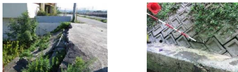
図-2.6 平成26年度末時点で榎井川水系で確認される損傷等
