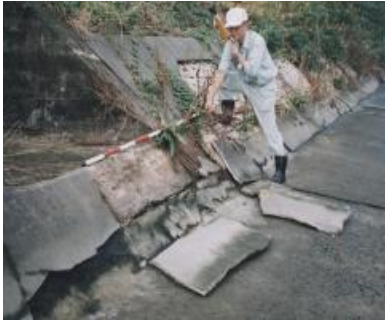
図 1.12 老朽化護岸の状況
