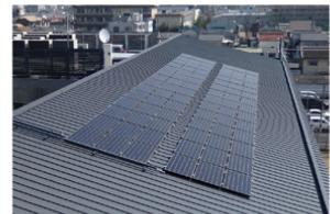
太陽光発電設備のシステム (20Kw)
