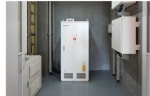
太陽光発電設備のシステムと連動した蓄電池
