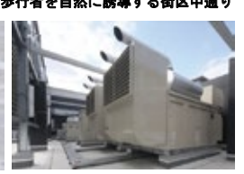
非常用ディーゼル発電機
