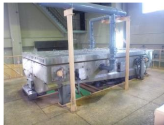
写真 17 省エネ機器の例 (ベルト式ろ過濃縮機)
