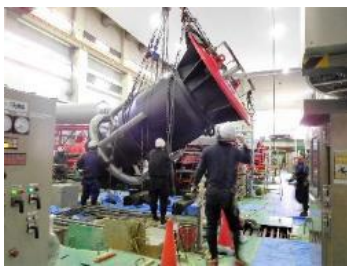
写真6 機械設備の改築更新の例(ポンプ)
