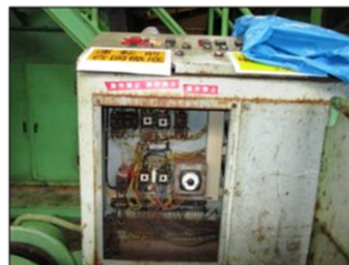
写真4 施設の劣化状況
