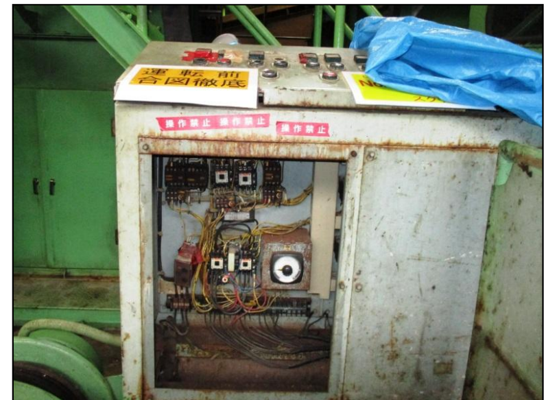
電気設備 操作盤
