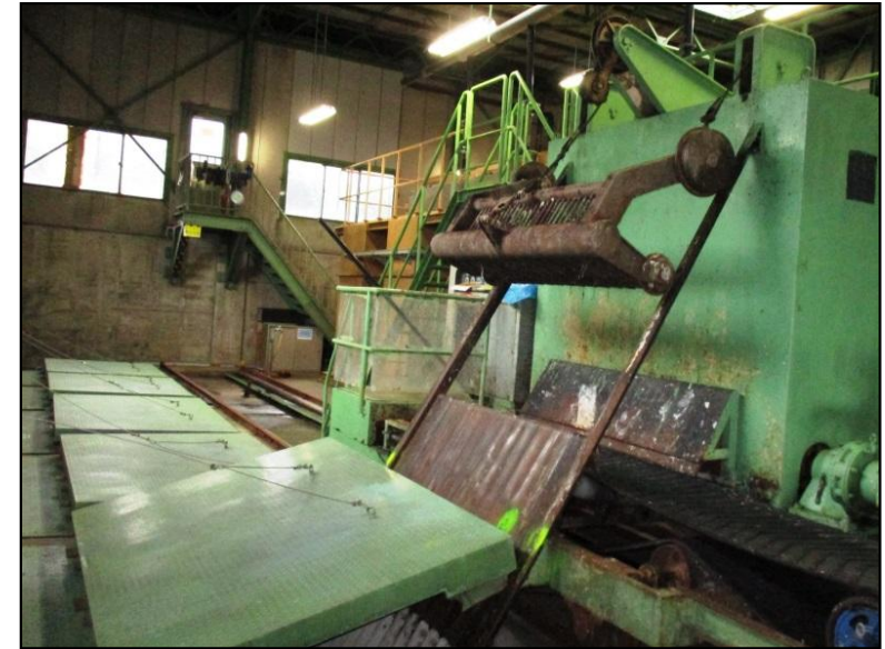
機械設備 除塵機
