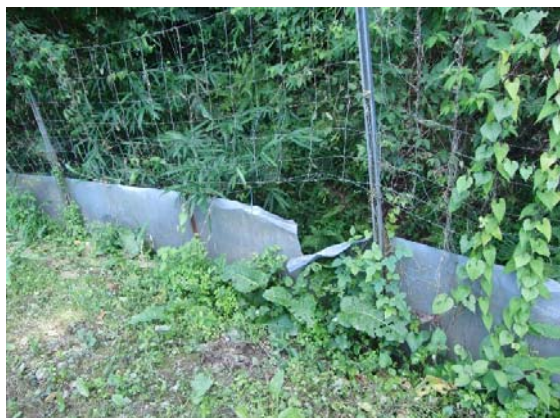
破損して侵入を許してしまった柵
