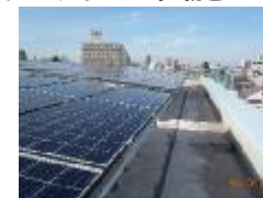
設置例：大阪市立東桃谷小学校
