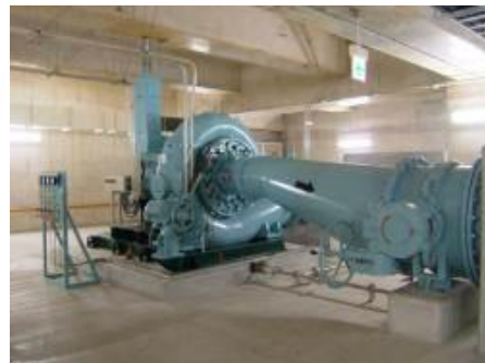
長居水力発電設備
