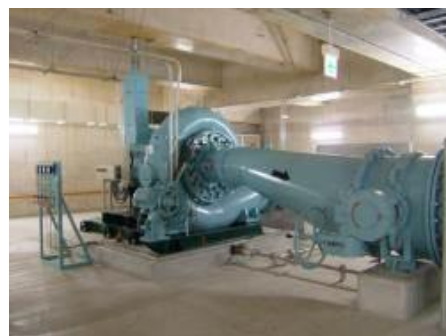
長居水力発電設備
