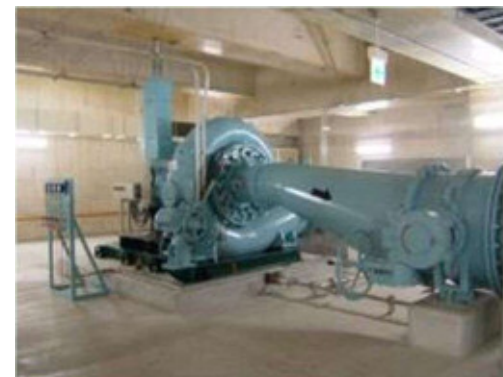
長居水力発電設備
