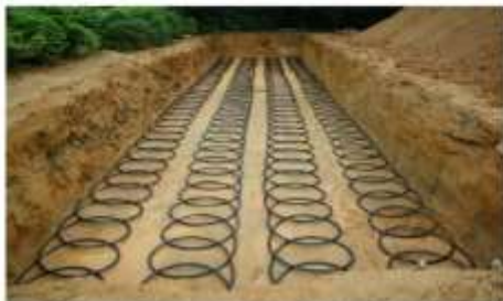
環境省 H22-23 年度地球温暖化対策技術開発事業で設置した水平型地中熱交換器
