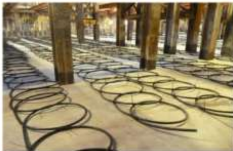
小田急電鉄東北沢新駅のトンネル本体の下に設置した水平型地中熱交換器 (地表下約15m)
