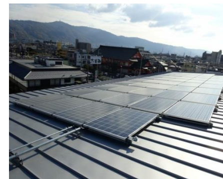
太陽光パネル
