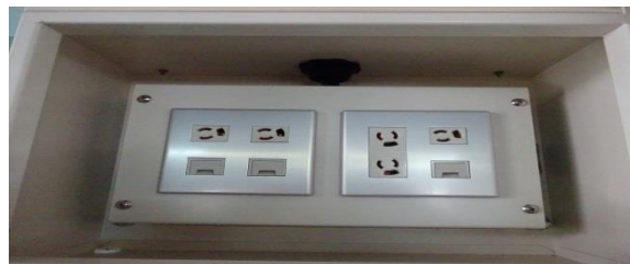
【非常用コンセント】
