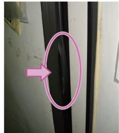
【パッキンの劣化】
