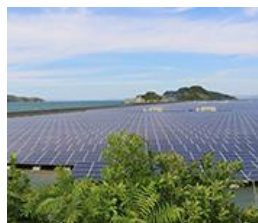
有田太陽光発電所
