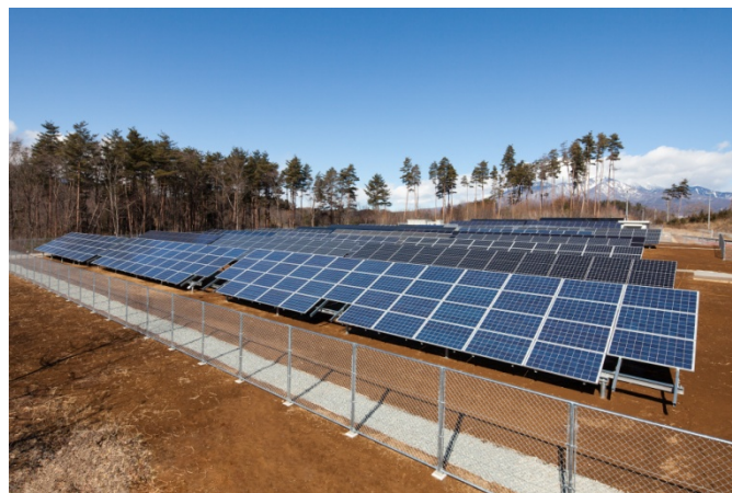
太陽光発電所
