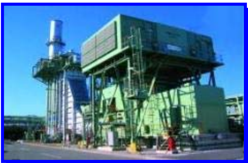
大阪ガス姫路発電所 4.6万kW
