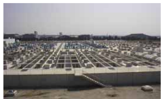
図-31 北部水みらいセンターの高度処理施設
