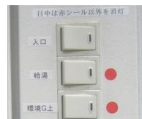
照明スイッチに部分消灯の範囲を明示
