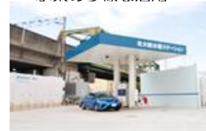
北大阪水素ステーション
