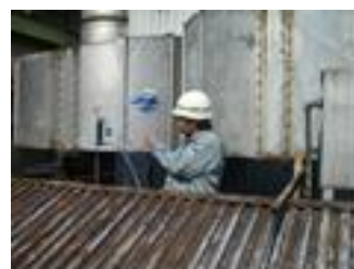
検査のために処理施設から排ガス採取
