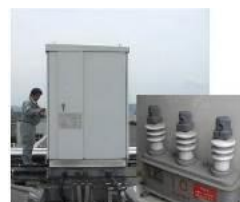
PCB 廃棄物（コンデンサ）保管状況の立入検査
