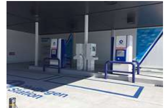
燃料電池フォークリフトの実証運用（関西国際空港）
