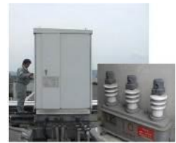
PCB 廃棄物(コンデンサー)保管状況の立入検査
