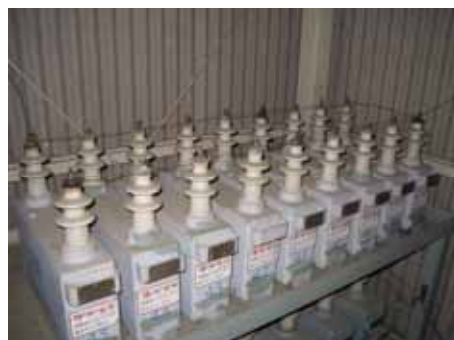
図-8 PCB含有コンデンサの保管状況
