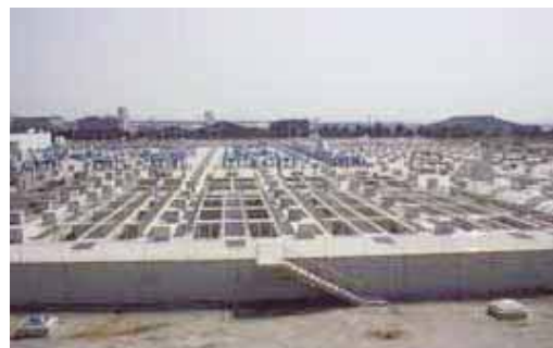
図-31 北部水みらいセンターの高度処理施設
