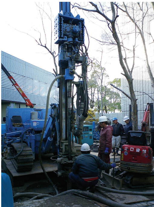
図-15 地中熱ヒートポンプシステムにおける熱交換井の掘削状況
