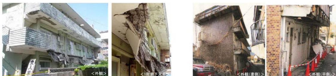
マンションの2階廊下部分が崩落した事例
