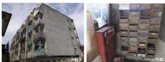
建物の傷みが著しく外壁の剥落、鉄骨の露出などが見られる事例
