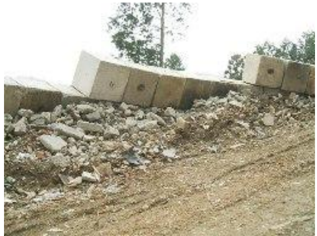
のり面の裏込め材に廃棄物を入れた例
