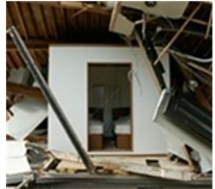
(耐震シェルターの例)
