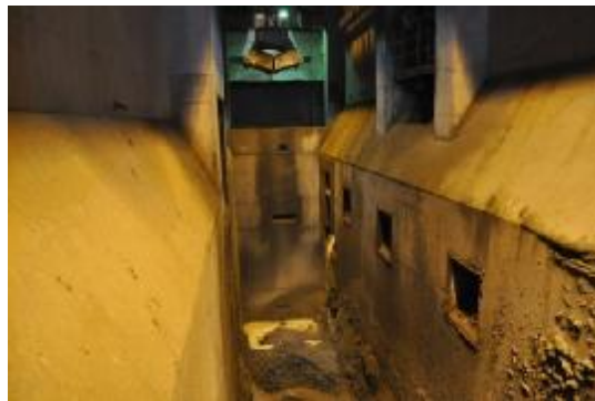
焼却灰のピット：焼却灰を保管する
