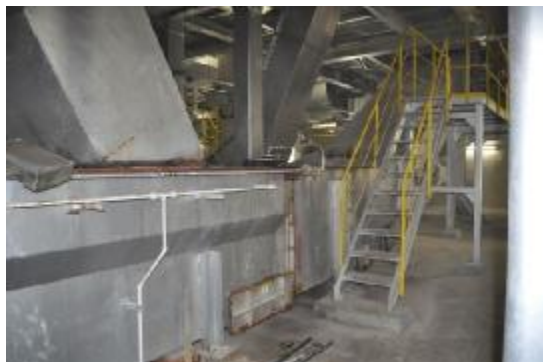
落下灰コンベア：水をためており、灰が冷却される
