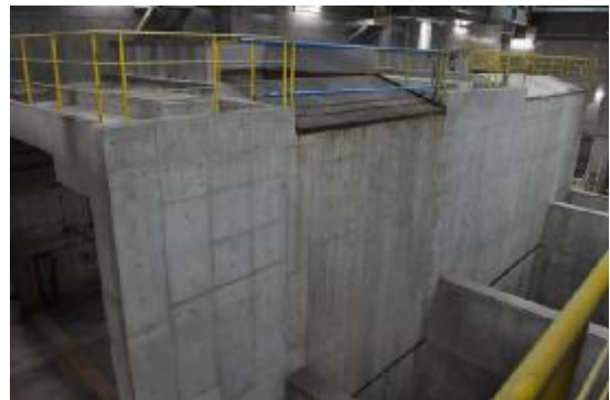
灰だしホoppa：上部から灰を投入し、下部にあるバンカが開いてダンプカーに灰を積込む
