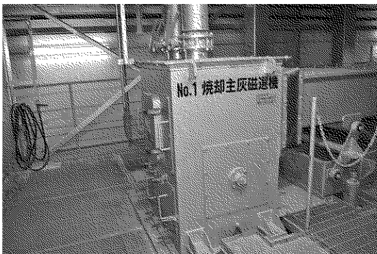
磁選機：主灰の中の金属を除去する
