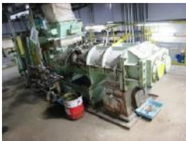
＜薬剤処理設備＞
