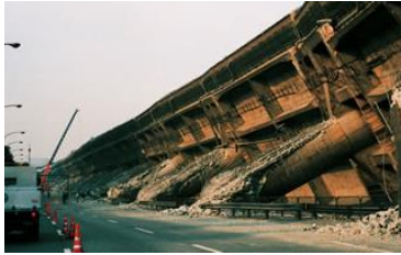
倒壊した阪神高速道路
