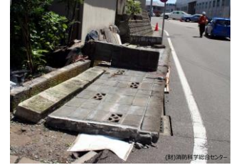
倒壊したブロック塀(新潟県中越沖地震)
