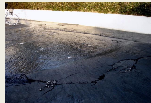
断水（水道管破損による漏水） (東日本大震災 千葉県船橋市)
