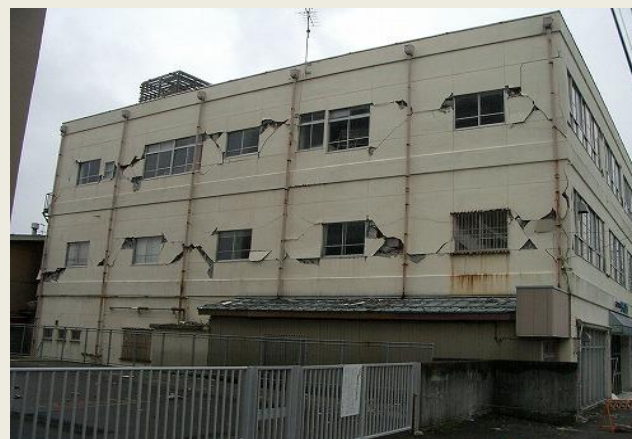
建物半壊（中越地震 十日町市）
