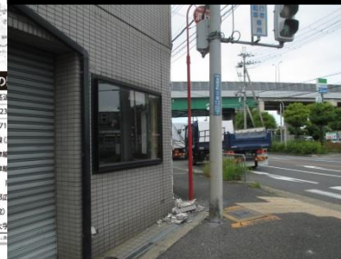
大阪高槻線 住宅壁面タイル剥がれ (摂津市鳥飼本町1丁目)
