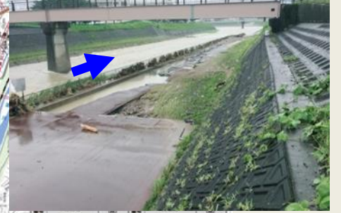
安威川宮之前東通学路橋上下流右岸 高水敷洗掘 (茨木市東安威~十日市町)
