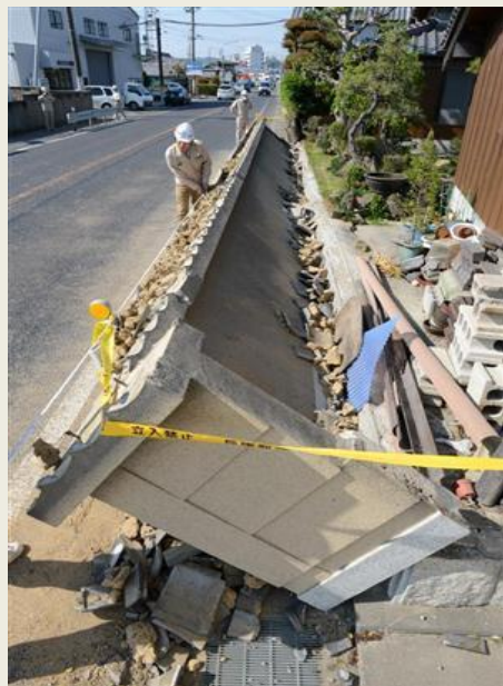
ブロック塀の倒壊 (淡路島地震 H24.4)
