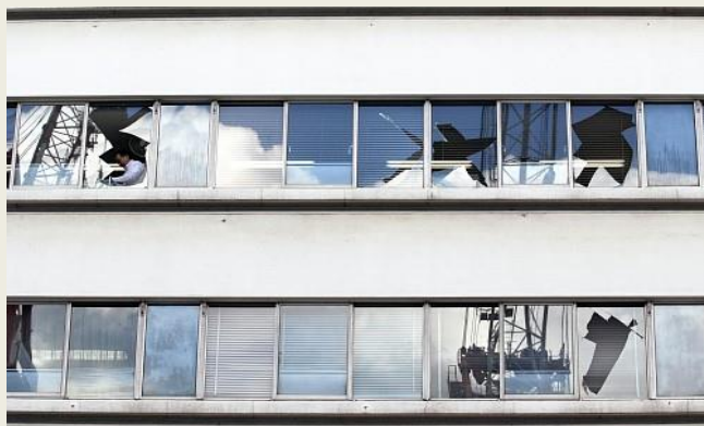
窓ガラスの破損 (東日本大震災 東京都中央区)
