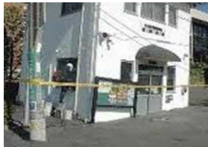
使用停止となった交番（全壊） （東日本大震災：我孫子市） 出典）我孫子市
