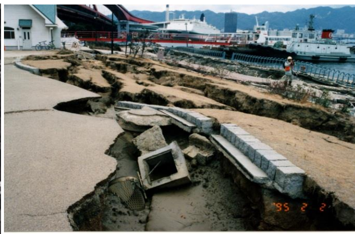
港湾護岸の側方流動（阪神淡路大震災） 出典）神戸市HP
