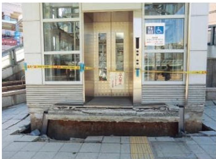
段差の発生により、使用不能となった エレベータ（東日本大震災） 出典）浦安市HP
