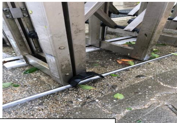
中学校北門の破損
