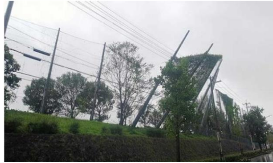
防球ネットフェンスの倒壊
