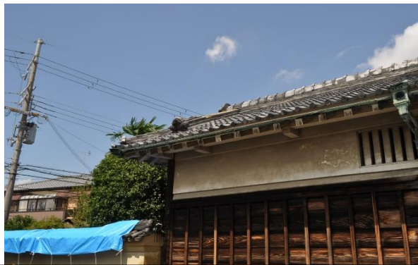
国登録有形文化財・山野家住宅破損
