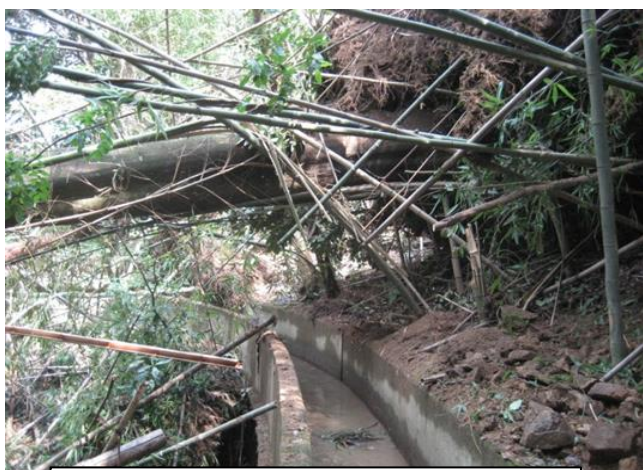
水路内、倒木被害により閉塞
