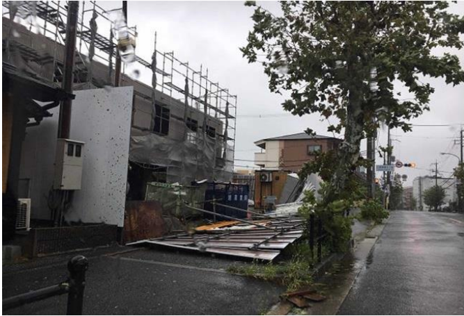
工事現場の仮囲い倒壊
