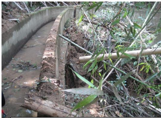
水路護岸、水路閉塞に伴う溢水により崩落
