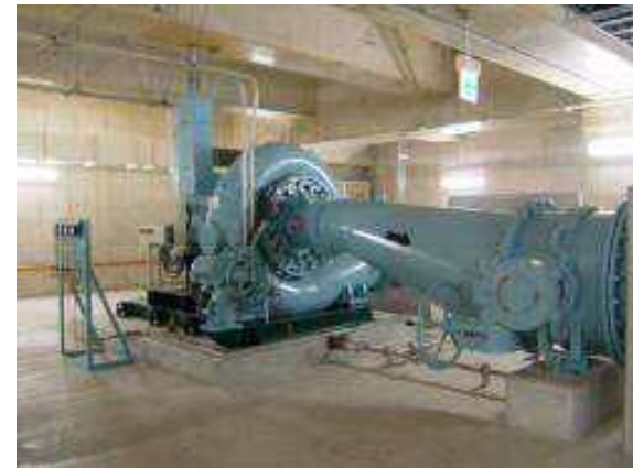
長居水力発電設備（253kW）
