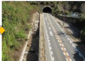
緊急対応業者により崩土等を除去し、速やかに交通開放
