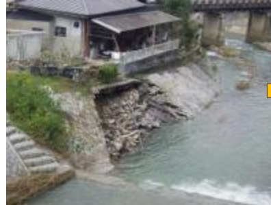
河床洗掘により護岸が崩壊し、護岸背面の人家にも影響が及び一刻をあらそう非常に危険な状況。
