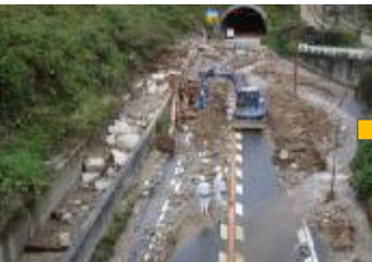
道路上に土砂や流木が流出。全面通行止め措置。
