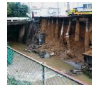
河床洗掘による護岸の崩壊により民有地に影響あり
