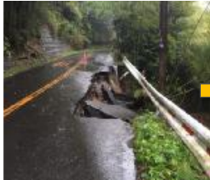
路肩が崩壊し全面通行止め措置
