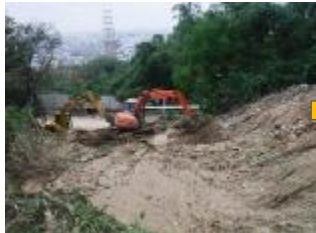
緊急対応業者により崩土等を除去作業を開始
