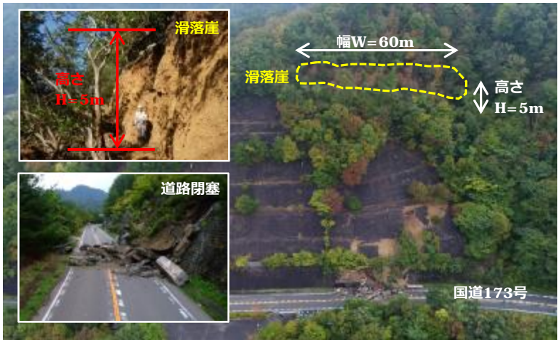
法面崩落箇所全景（ドローンによる撮影）
