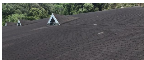
雨漏りが発生する屋根
