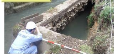
【R2.7月豪雨】 (熊本県錦町)
