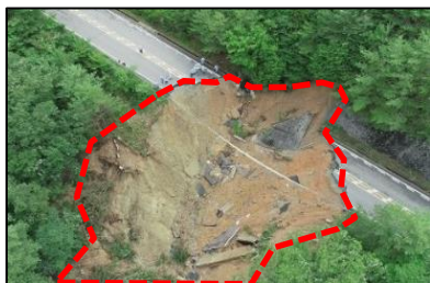
平成30年7月豪雨による 道路法面被害(国道173号)
