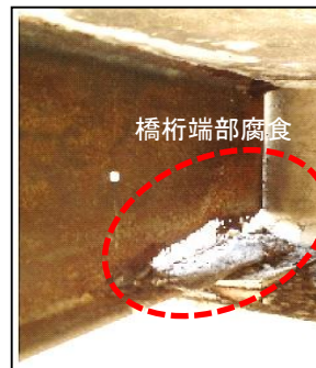
橋梁の橋桁の腐食
