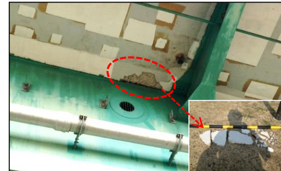
橋梁におけるモルタル片の剥落
