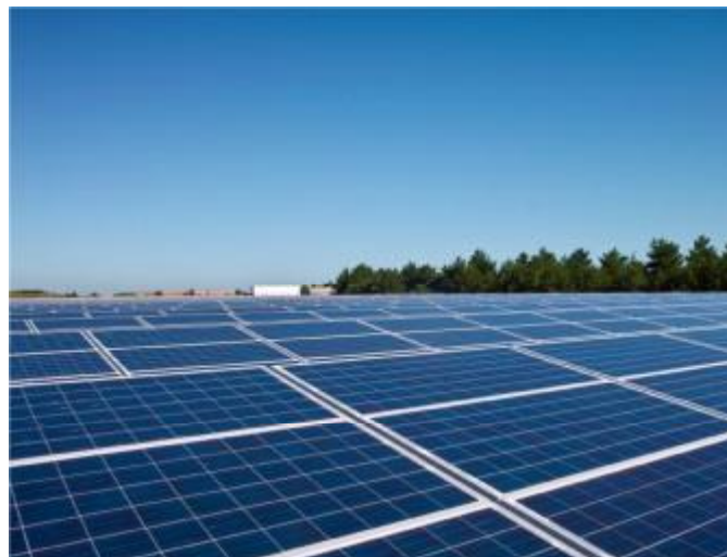
図 7.2-3 南部水みらいセンターのメガソーラー
