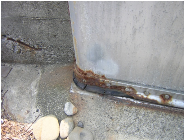
水密ゴムの亀裂
