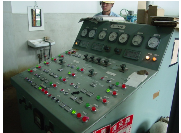
電気設備の陳腐化
