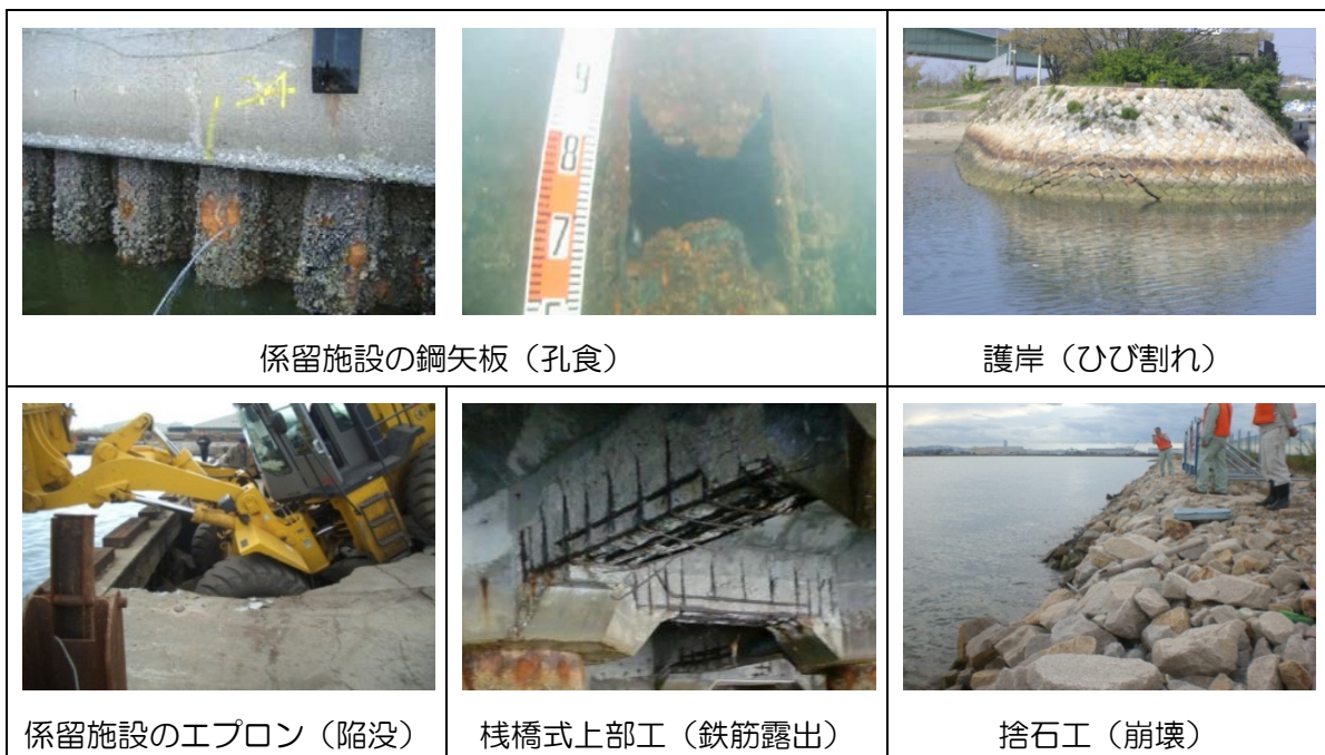
写真 2.1-1 主な港湾施設の劣化状況
