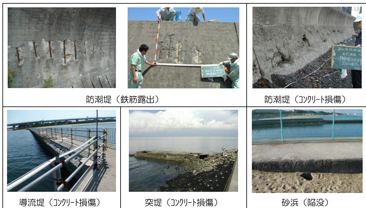
写真 2.1-2 主な海岸施設の劣化状況
