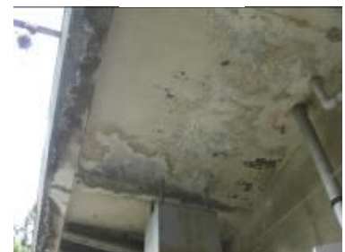
コンクリートの剥離、クラック、鉄筋露出
