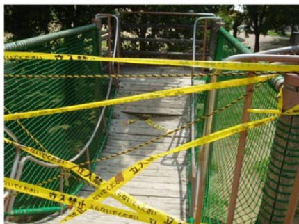
劣化による破損（利用停止）
