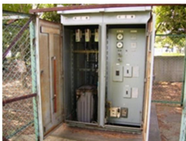
耐用年数超過盤の腐食
