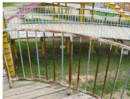
劣化による腐食
