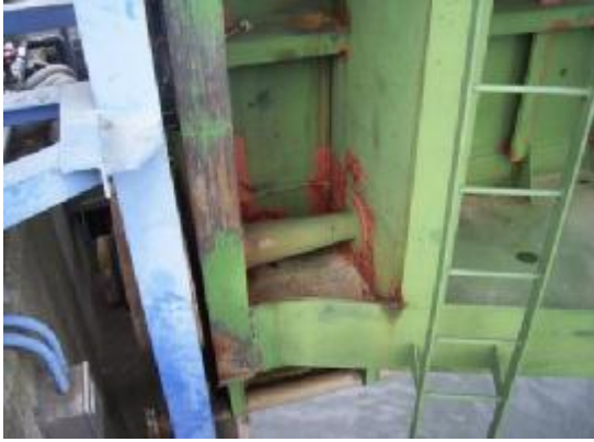
水門扉体の腐食状況
