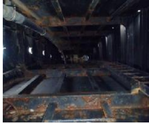
水門扉体内面の腐食状況
