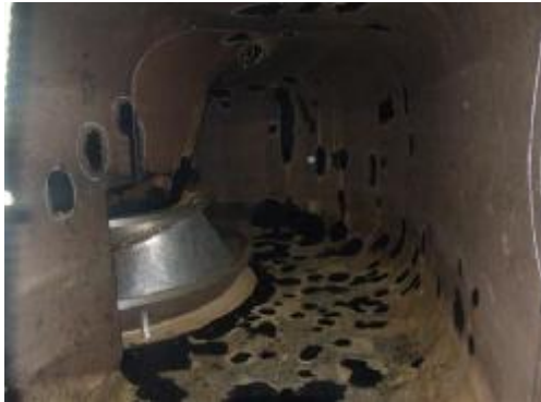
ポンプケーシング内部の孔食状況
