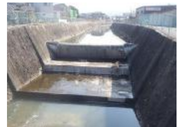
（ゴム引布製起伏堰（参考））
