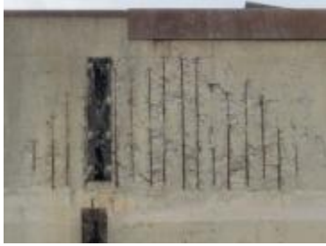
剥離・鋼材露出
