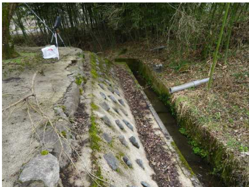
側溝や排水路
